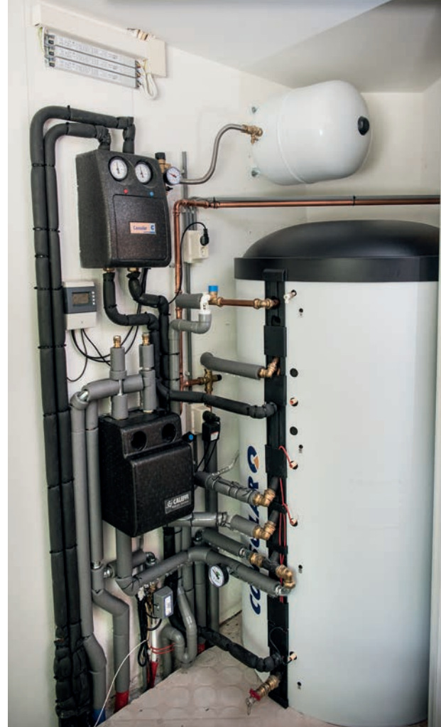
'Het buffervat zorgt voor 'rust' in de installatie doordat niet elke piek vanuit de ketel hoeft te worden afgedekt.'
